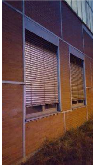
Foto 38: Potentiell für die Zwerg- fledermaus geeignetes Spaltenquartier an den im Untersuchungsgebiet befindlichen Gebäuden: Rollladenkästen
