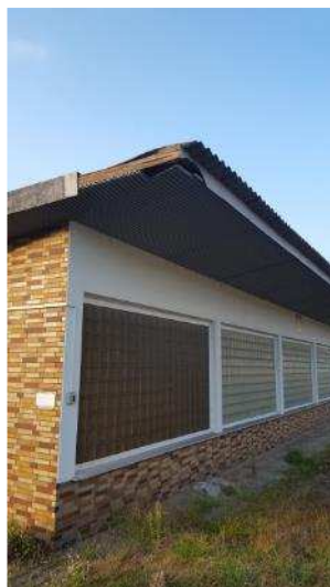
Foto 40: Potentiell für die Zwerg- fledermaus geeignetes Spaltenquartier an den im Untersuchungsgebiet befindlichen Gebäuden: Öffnung im Dachbe- reich
